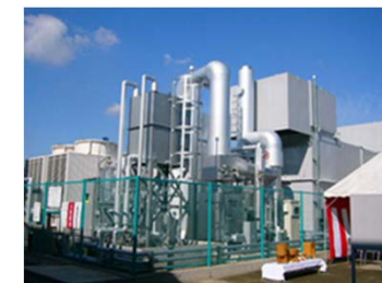
天然ガスコージェネレーション (小山化学株式会社)
