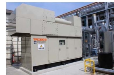
コージェネレーションシステム(滋賀工場)
