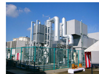
天然ガスコージェネレーション (小山化学)
