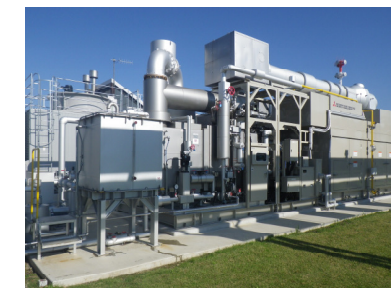
コージェネレーションシステム(東京工場)
