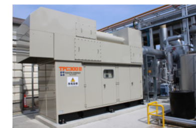
コージェネレーションシステム(滋賀工場)
