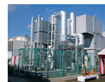
天然ガスコージェネレーション(小山化学)
