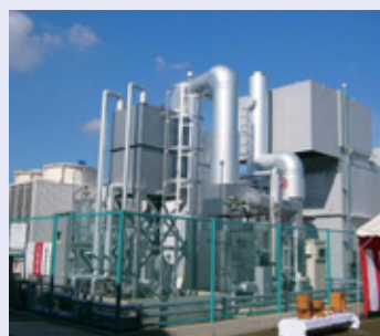
天然ガスコージェネレーション（小山化学）
